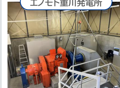
エノモト重川発電所
