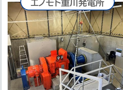
エノモト重川発電所
